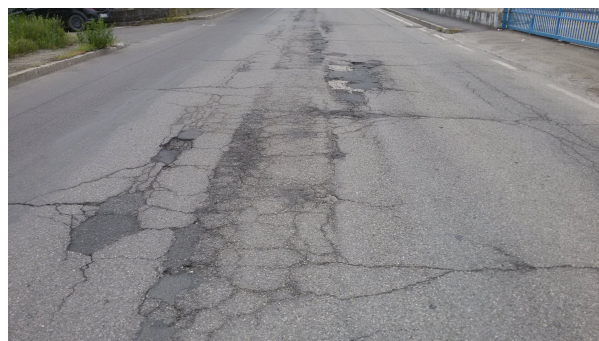
condizioni del manto stradale su via Nuova dei Campi
