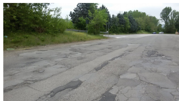
condizioni del manto stradale su via Sagittario
