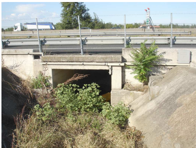
Figura 5-6- Imbocco sud del canale sotterraneo del R. Casella sulla A1. Dimensioni: circa 2 m di ampiezza per 1,5 m di altezza.
